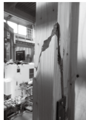
図 2-8 柱の引張破壊
